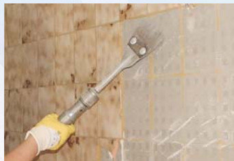
Abstoßen von Fliesen und Platten
